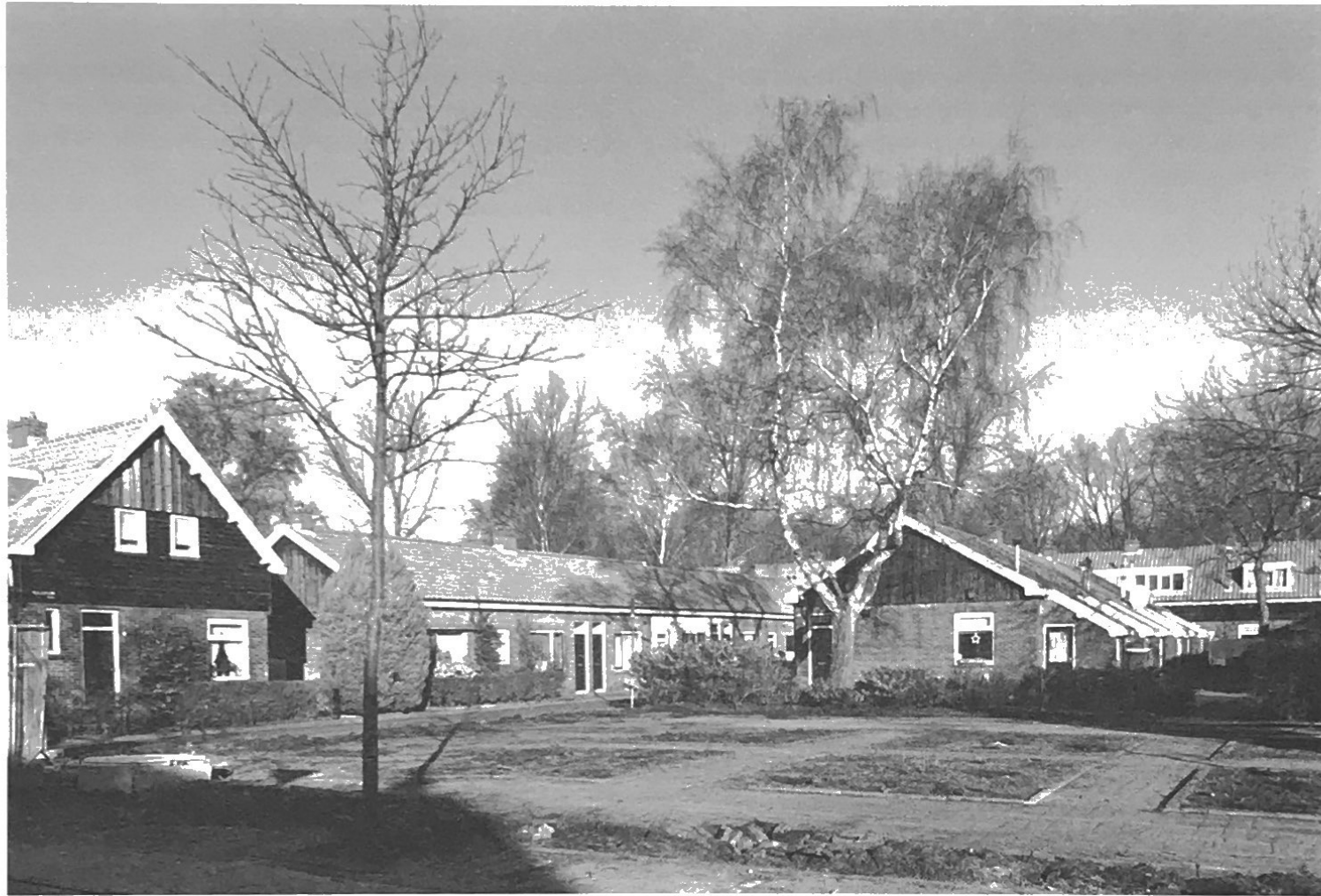
Eerste werkzaamheden in Vogeldorp, Vogelplein. Hier komen de keten van de aannemer en opzichter.
